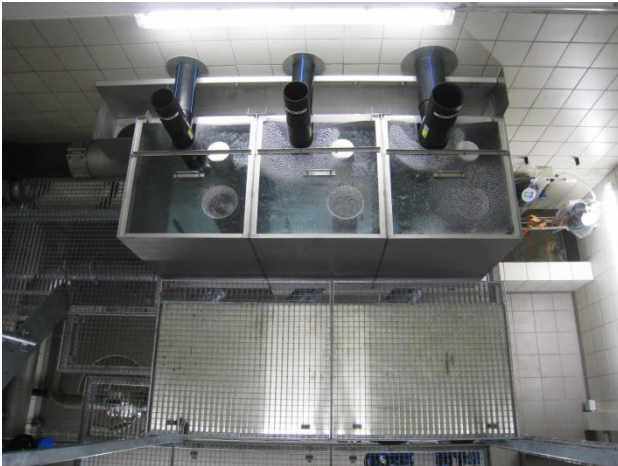
Beweissicherung/Monitoring kommunale Quellwasserfassung.
