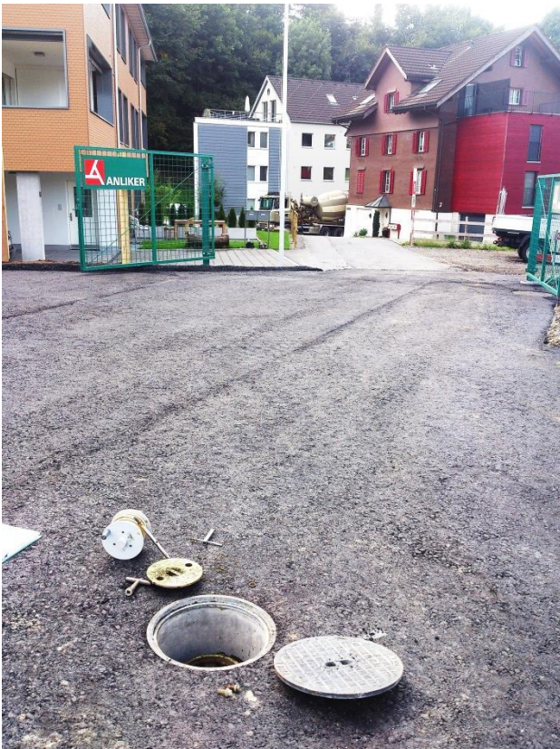
Grundwasser-Beobachtungsbohrung (mit / ohne Data-Logger).
