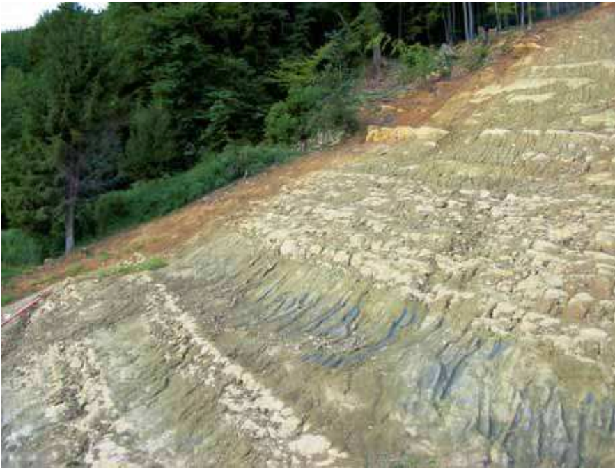
Abb.3: Im Westteil von Laugneri: nach dem Abtrag der Rutschmassen vom August 2005 zeigte sich, dass die Lockergesteinsmächtigkeit in diesem Bereich erwartungsgemäss weniger als 2 m mächtig war (Foto: K. Louis).
