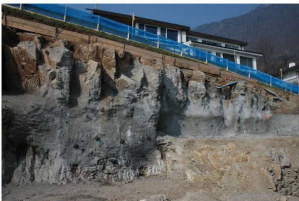
Baugrube Gotthardstrasse – Stark zerblockte, hangauswärts fallende Nagelfluhbänke auf gleitfähigen Mergelbändern
