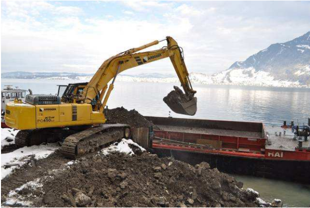
Der Verlad des Sturzmaterials erfolgt mit dem zweiten Raupenbagger auf das Verklappungsschiff.
