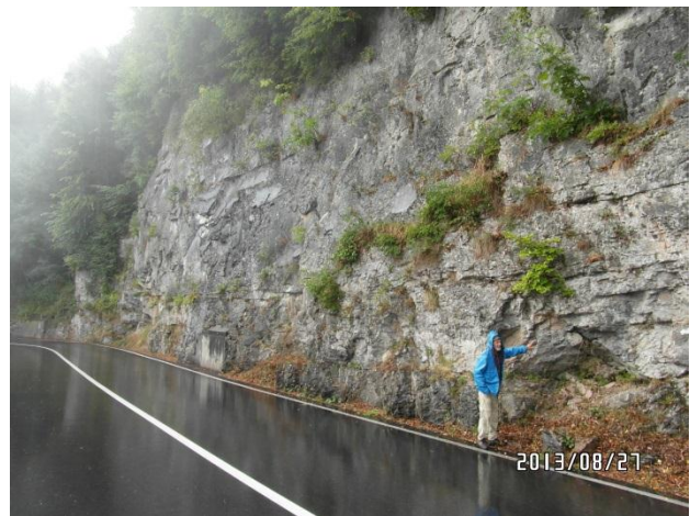
Aufnahme von Schäden und Ereignissen.
